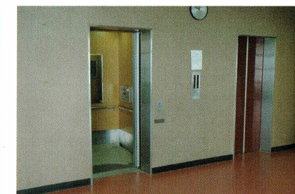
エレベーター(2基)
