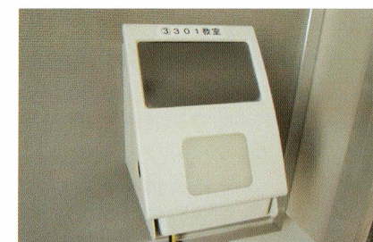
出欠管理用カードリーダー(全教室)
